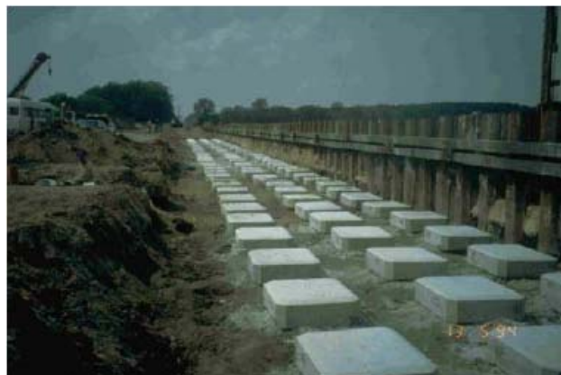
Figure 4 – Chantier de remblai ferroviaire, visualisation des têtes d'inclusion avant l'édification du remblai, d'après Zanziger et Gartung (2002)
